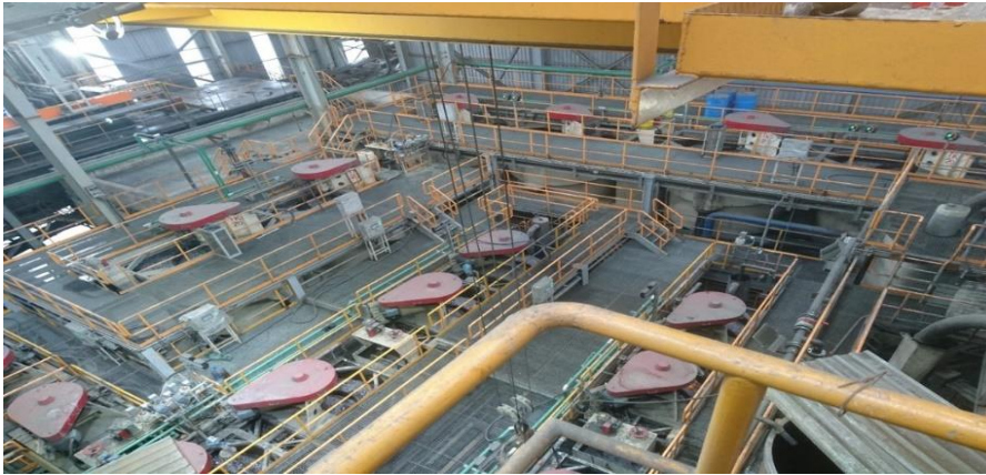
Şekil 7. Samsun-Tekkeköy Cevher Zenginleştirme Tesisi (Eti Bakır A.Ş.)
